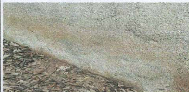
Foto 6: Repello en mal estado
