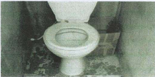
Foto 8: Baño en mal estado
