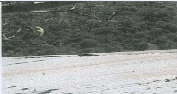
Foto 3: Capote de lamina ya en muy mal estado
