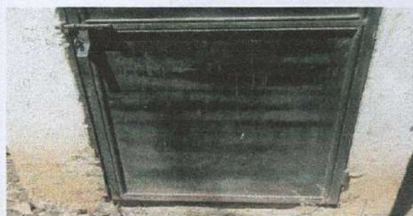
Foto 4: Puertas de metal para dar mantenimiento
