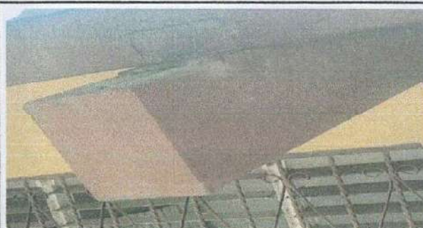
Foto 2: Costaneras se encuentran ya en mal estado
