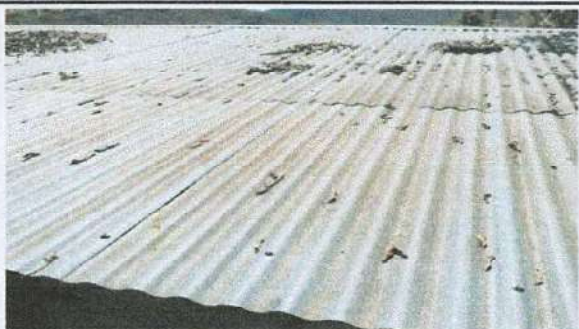
Foto 1: Techo con laminas en mal estado
